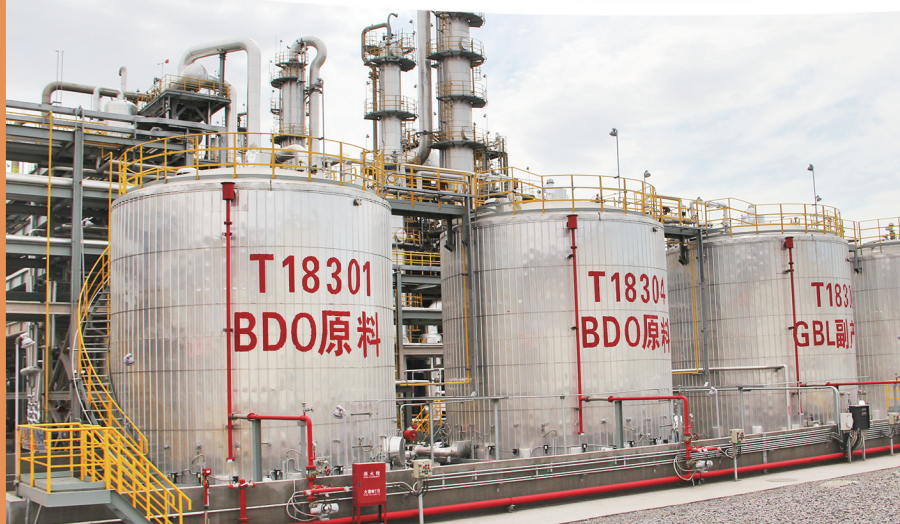
东景生物环保科技有限公司BDO原料罐区。
