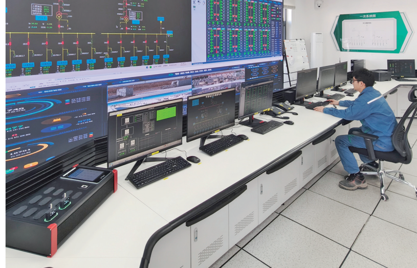
中国绿发集团半固态锂电池储能电站主控室。
