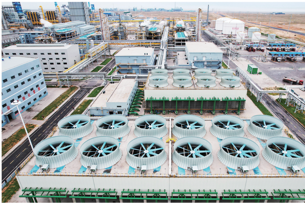
内蒙古华恒能源科技有限公司工业冷却塔。(赵政宇 摄)
